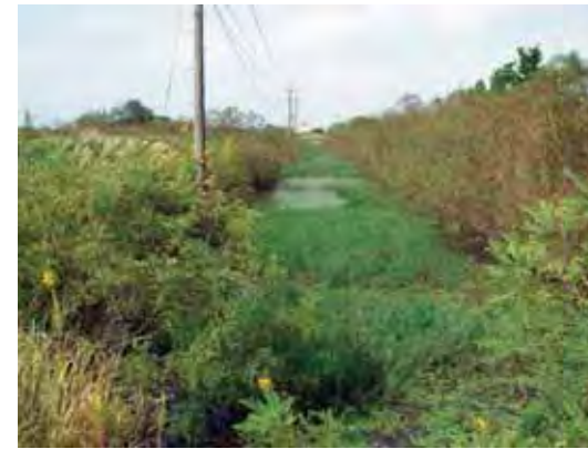
水路の通水阻害、ポンプ場の目詰まり
